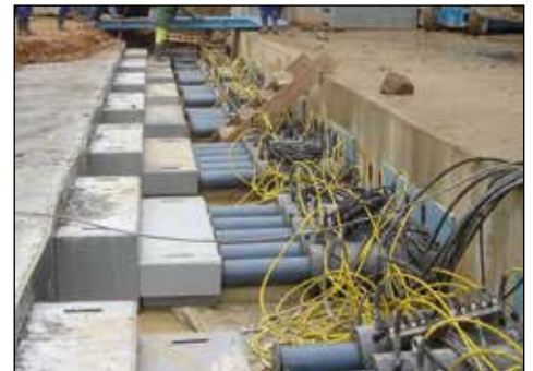
▲ Împingerea cu cricuri: sistem sincron multi-punct utilizat pentru împingerea hidraulică a segmentelor de tunel sub calea ferată.
